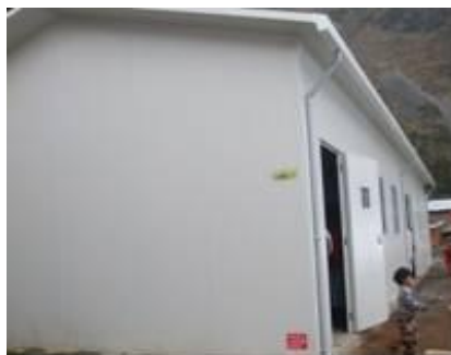
Nueva CE.de Huaytará, afectado por sismo
