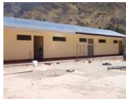
Nuevo CEMx.Fco Bolognesi de Tantará, afectado por sismo
