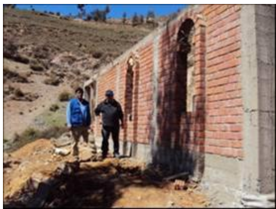
Seguimiento Construc.Cementerio Gnal. Laramarca, afectado por el sismo
