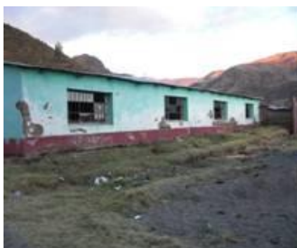
IE afectada por sismo 2007-Quirahuará
